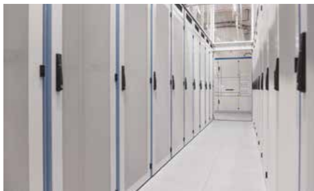
Jedna z serwerowni w Centrum Kompetencji STOS, w której pracuje superkomputer Kraken PG. Fot. Bartosz Bańka/PG
